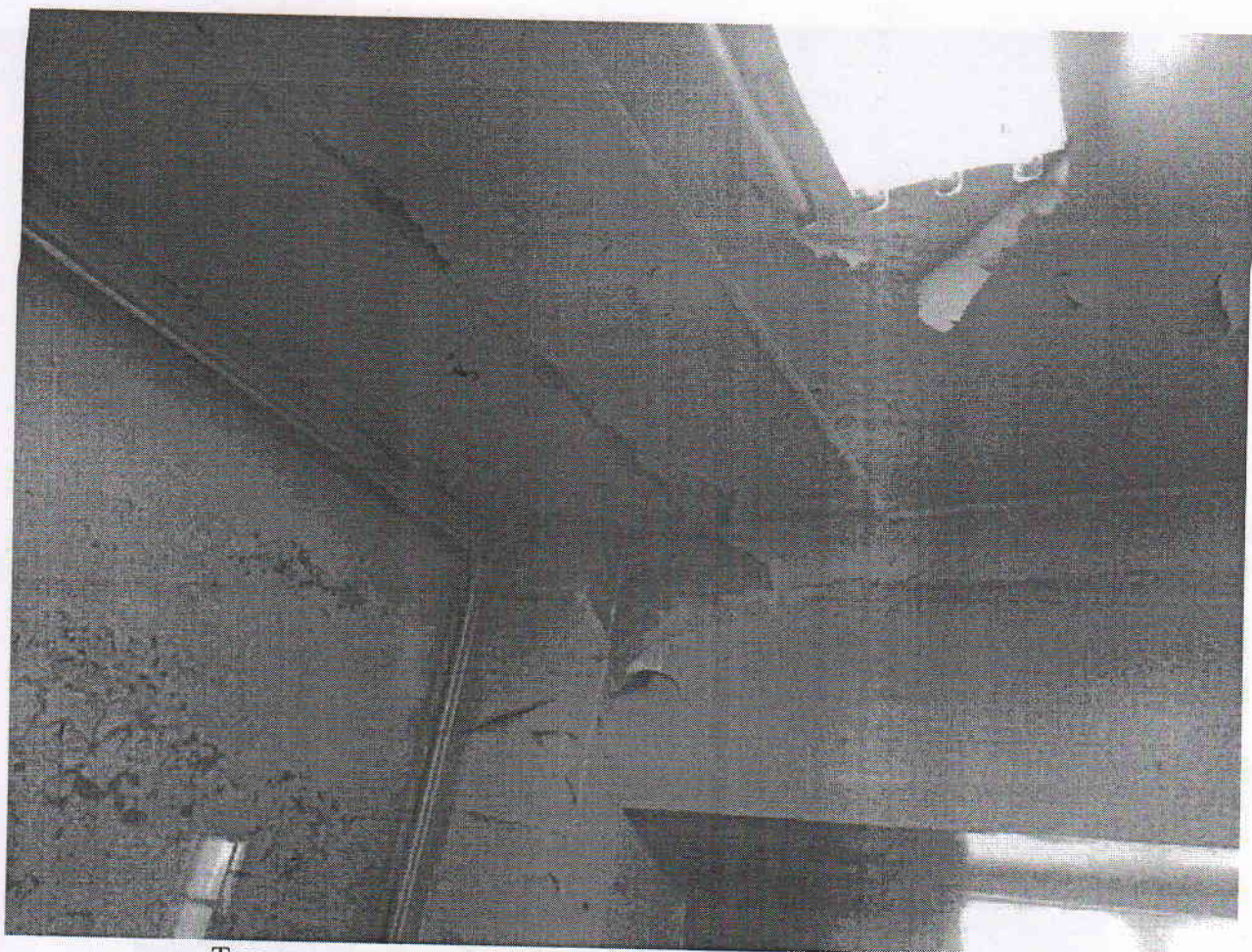
Трещины в перекрытиях и стенах пристроенных помещений.
